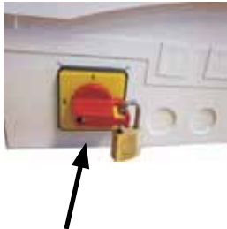
hlavný servisný vypínač
