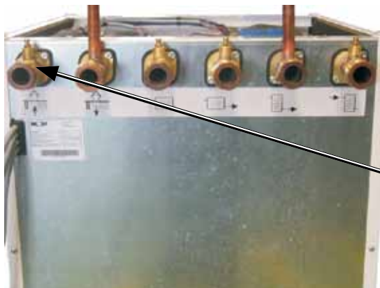
ručný odvzdušňovací ventil vo vstupe soľanky
